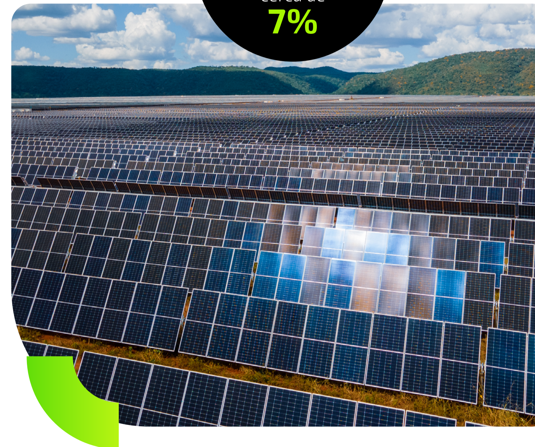
Usina Hélio Valgas, localizada em Várzea da Palma (MG).
