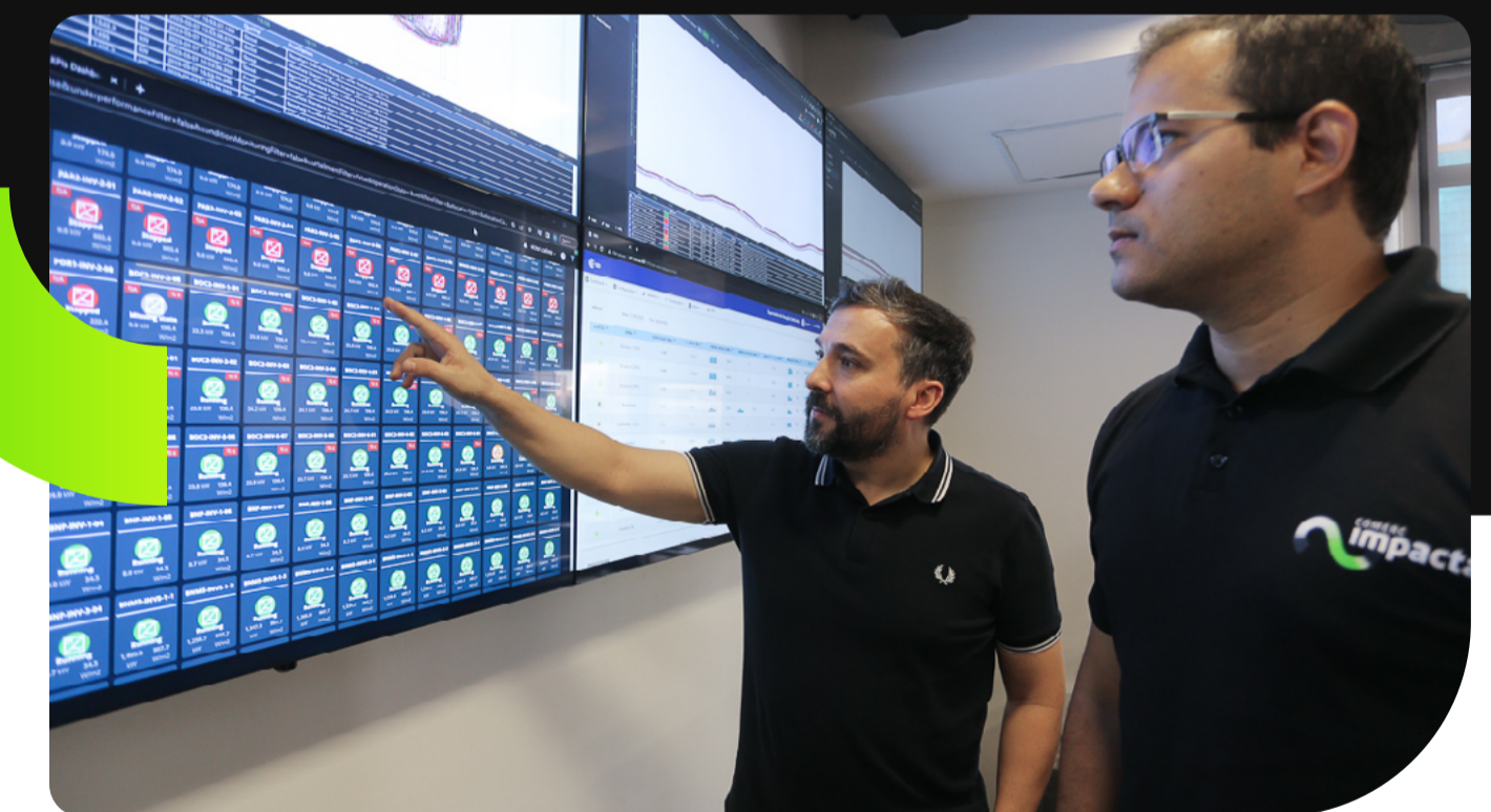
Centro Remoto de Operações (ROC)
